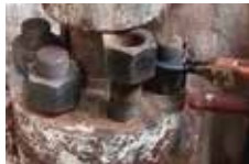
Dégrippage Boulon industriel Inducteur boucle L180
